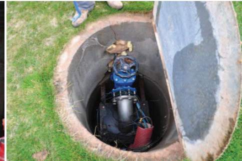
Pozo de bombeo del campo de golf.
