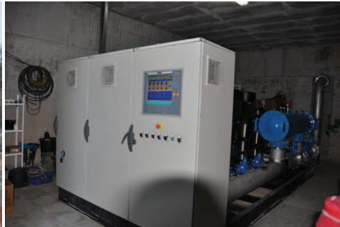
Sistema de control del bombeo y riego.
