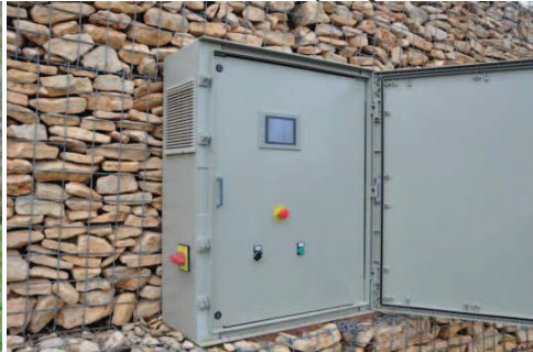
Caja de control de la recirculación de los lagos.
