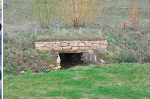
Salida del drenaje de arenero.
